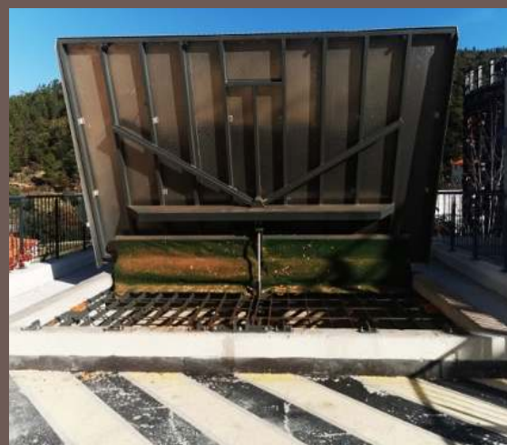
Extérieur de la chaufferie : trappe carrossable
