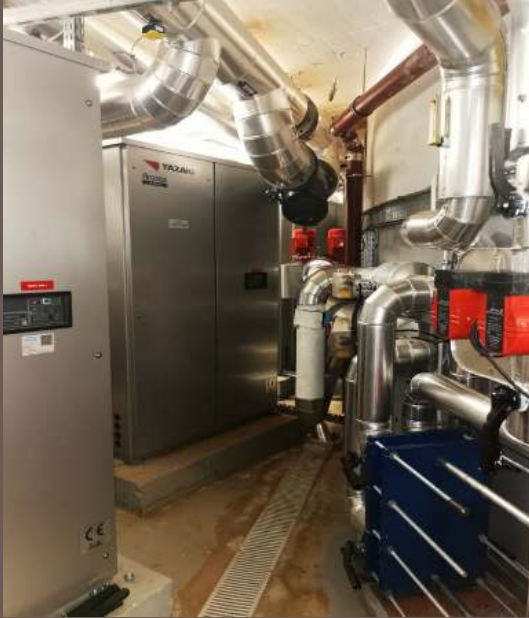
Intérieur de la chaufferie
