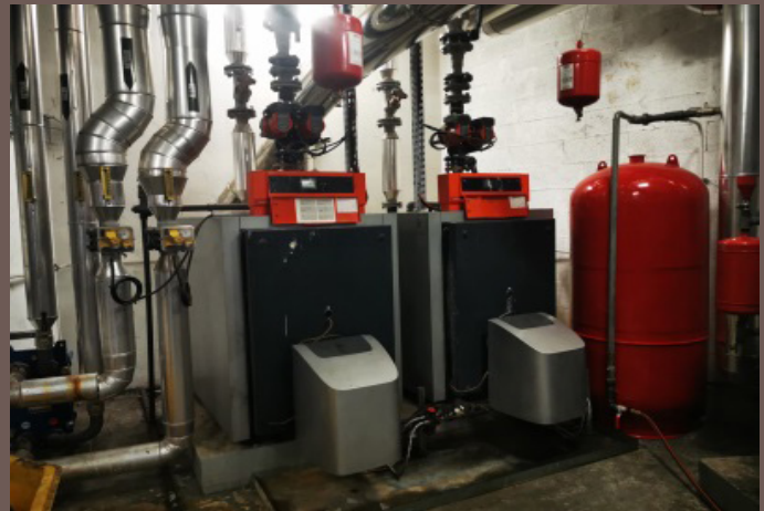
Chaudières fioul en cascade marque VISSMANN
