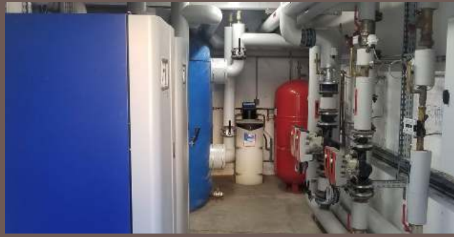
Intérieur de la chaufferie
