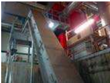
La chaudière et le convoyeur
