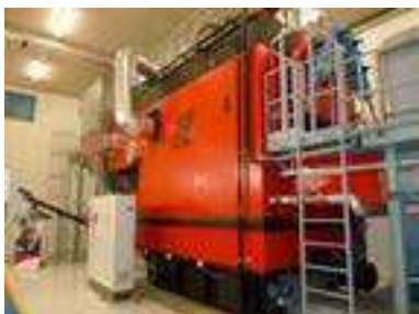
La chaudière bois de 2,9 MW
