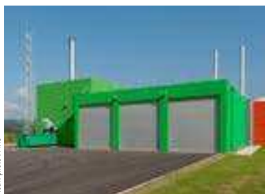
Chaudière bois : vue des trois silos de stockage de combustible et de la benne à cendres
