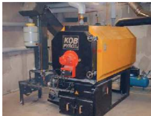
Photo 1 : Vue intérieure de la chaufferie bois
